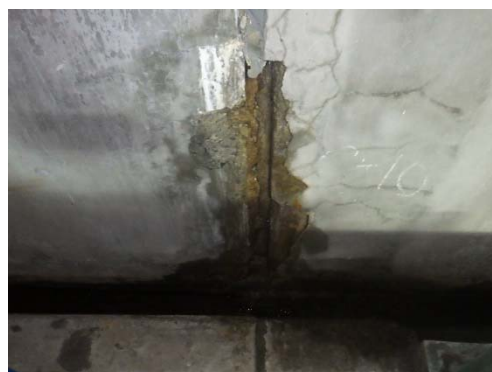
図-3 剥離箇所状況（正面より撮影）
