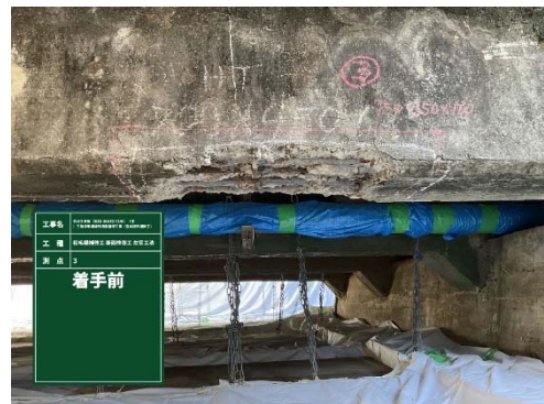
松毛橋（損傷状況）
