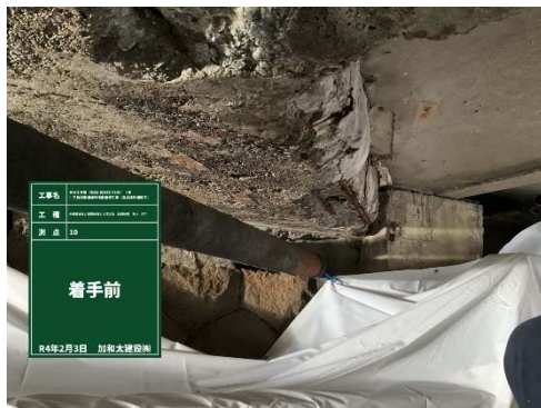
小浜橋（損傷状況）
