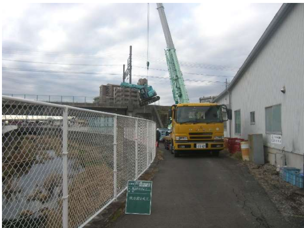
(下り線側) 小型クローラークレーン吊上げ状況 50 t ラフタークレーン使用 (写真-5)
