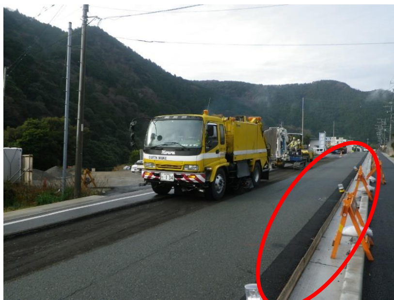
(既設舗装が計画より 18 cm高い箇所)
