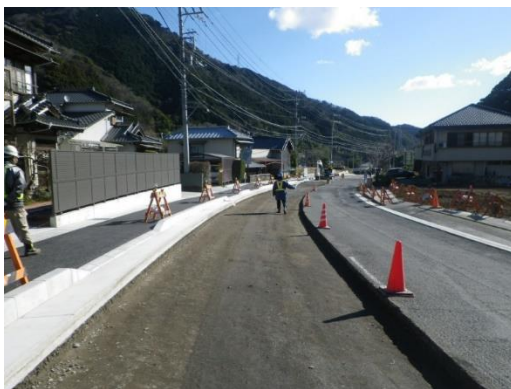
(民地前 27cm 段差状況)
