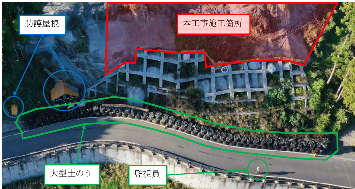
【 町道小鍋峠線への防護対策：大型土のう設置と監視員の配置 】
