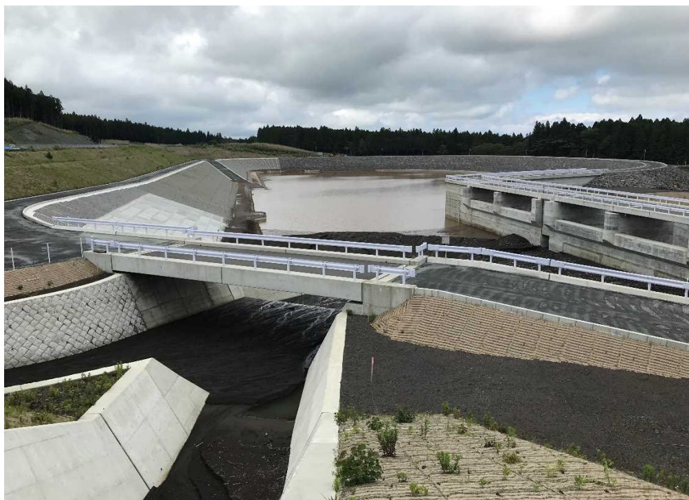
6月2日記録的な豪雨後の境沢川調節池の状況 ※付帯工事による演習場入場許可あり
