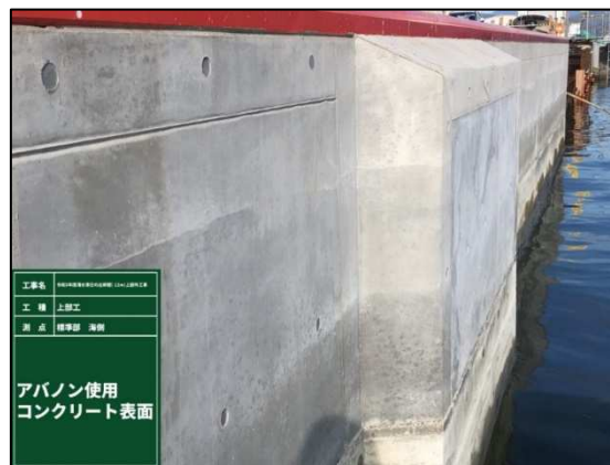
脱型後コンクリート表面
