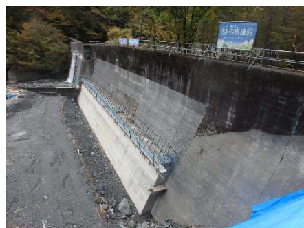
被災時現場状況
