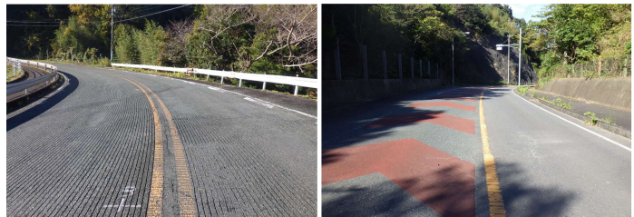
写真-2 既設縦型グルーピング
