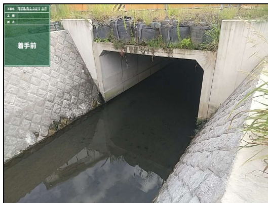
写真-1 函渠内滞水状況
