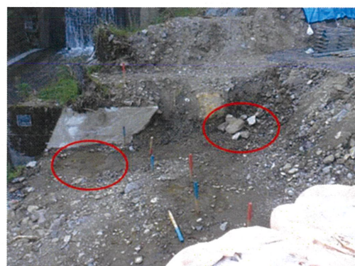
写真-2 左岸側湧水
