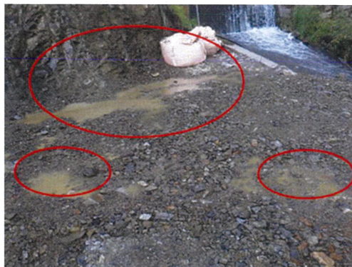
写真-1 右岸側湧水
