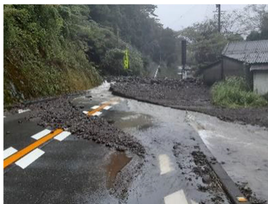
写真-2. 台風 15 号による災害状況
