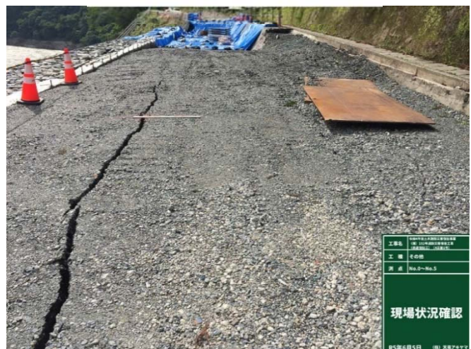
路床クラック確認
