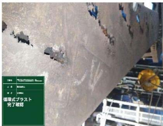
腐食の状況（主桁・ササラ部）
