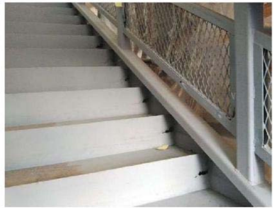
腐食の状況階段蹴込み部
