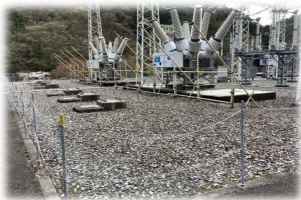
構内電気設備
