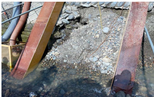
掘削時背面からの湧水
