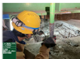
腐食状況確認
